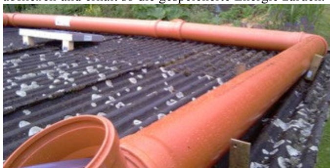
(Das Rohrsystem des Pumpspeichers und die Solarzelle auf dem Hüttendach)
